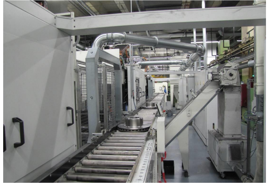
Rollenbahn für LKW-Bremsscheiben
